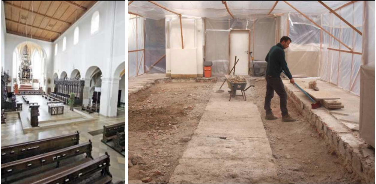
Abb. 1 Links: die alte Altarinsel (Foto: Christian Willner; http://www.sankt-kastulus.de/kirchen/index.htm ) Rechts: Die Baustelle zu Beginn der Maßnahme gegen Norden.
